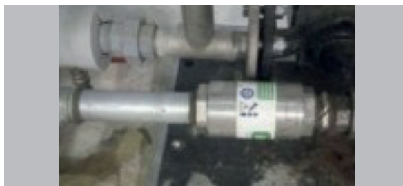
EF-i40 et EF-i65 installés sur bouclage ECS
