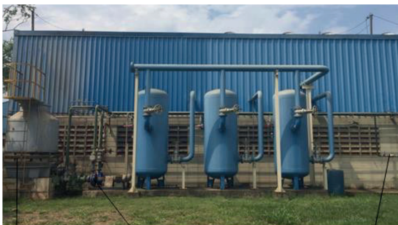
Tour de refroidissement
