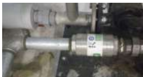
EF-i40 et EF-i65 installés sur Bouclage ECS
